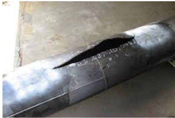
Fig. 5. Fracture of a pipe with longitudinal crack (Ministère du Développement durable, 2014)
