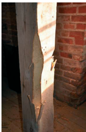
Fot. 9. Fragment gotyckiej więźby dachowej z elementem wymienionym podczas konserwacji w latach 70. XX w. Prawie całkowite zniszczenie elementu przez spuszczała pospolitego
