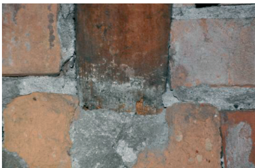
Fot. 10. Żerowisko krokwiowca piłkorożnego w zagrzybionym miejscu styku krokwi z murem. Pozostała większość krokwi bez objawów biokorozji
