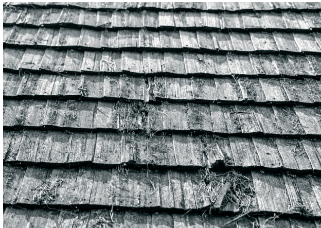
Ryc. 3. Przykład pokrycia dachowego (olejarnia z poł XX w.) – dach dwupołaciowy pokryty gontem. Przykład powierzchni ‘trudnej’ w dokumentacji tradycyjnej - zróżnicowana forma, zanieczyszczona, o niejednorodnej fakturze. Muzeum Wsi Radomskiej. [Fot. R. Zapłata]
