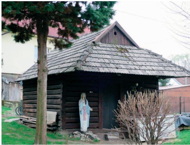
Fot. 5. Sułkowice, ul. Kowalska 81, kuźnia z okresu międzywojennego w dobrym stanie, (fot. z 2015 r., autor)
