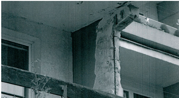
Rys. 4. Korozja ściany pionowej – filaru loggii
