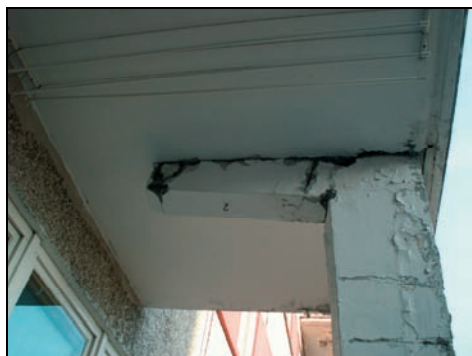
Rys. 4. Typowe uszkodzenia korozyjne płyty balkonowej i podpierającej ją konstrukcji wsporczej
