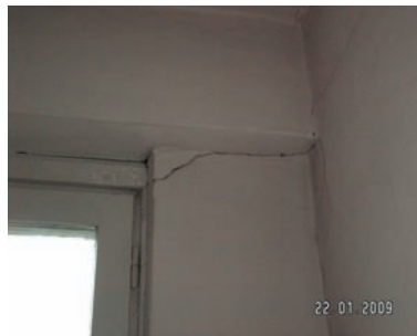
Rys. 13. Przykładowe pęknięcia na połączeniach obudowy i ścian poprzecznych wewnętrznych - klatka schodowa II
