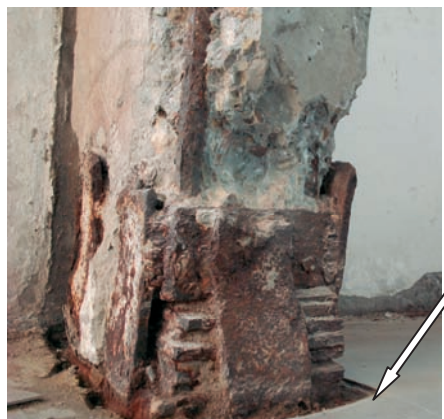
Rys. 7. Uszkodzenia jak obok. Wypełnienie przestrzeni pomiędzy płytą balkonu i podstawą słupa podkładkami stalowymi
