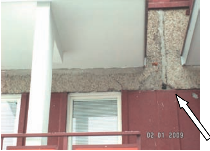
Rys. 15. Uszkodzenia płyt elewacyjnych
