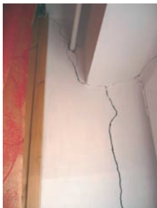
Rys. 12. Pęknięcie na połączeniu ściany zew. i elementu łącznikowego słupa o szer. do 2.5 mm (styczeń 2009), do 7 mm (styczeń 2014)
