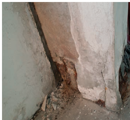
Rys. 6. Uszkodzenia korozyjne podstawy słupa
