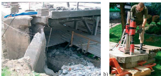
Rys. 3. Obraz częściowej rozbiórki z fragmentami betonu pobranego do badań laboratoryjnych, a) przyczółek od południa, b) pobieranie próbek
