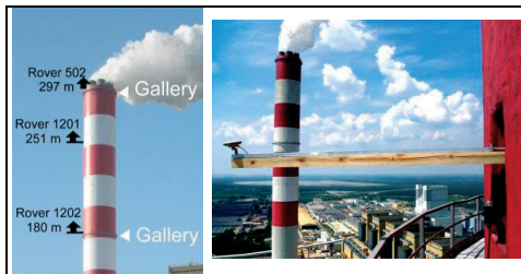
Rys. 4. Lokalizacja 3 anten GPS typu „rover” na kominie i sposób ich instalacji do elementów poziomych w dniach 20-24.05.2011r.
