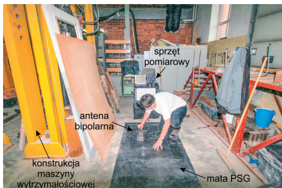
Rys. 1. Badanie konstrukcji podłogi w Regionalnym Laboratorium Budownictwa (Wydział Inżynierii Lądowej i Środowiska, Politechnika Gdańska) za pomocą metody georadarowej z użyciem maty PSG
