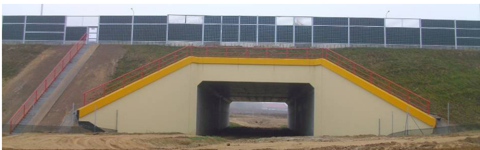
Rys. 9. Przejście dla średnich zwierząt na odcinku „Jastków” – „Lublin Sławin” (fot. M.Kowal).
