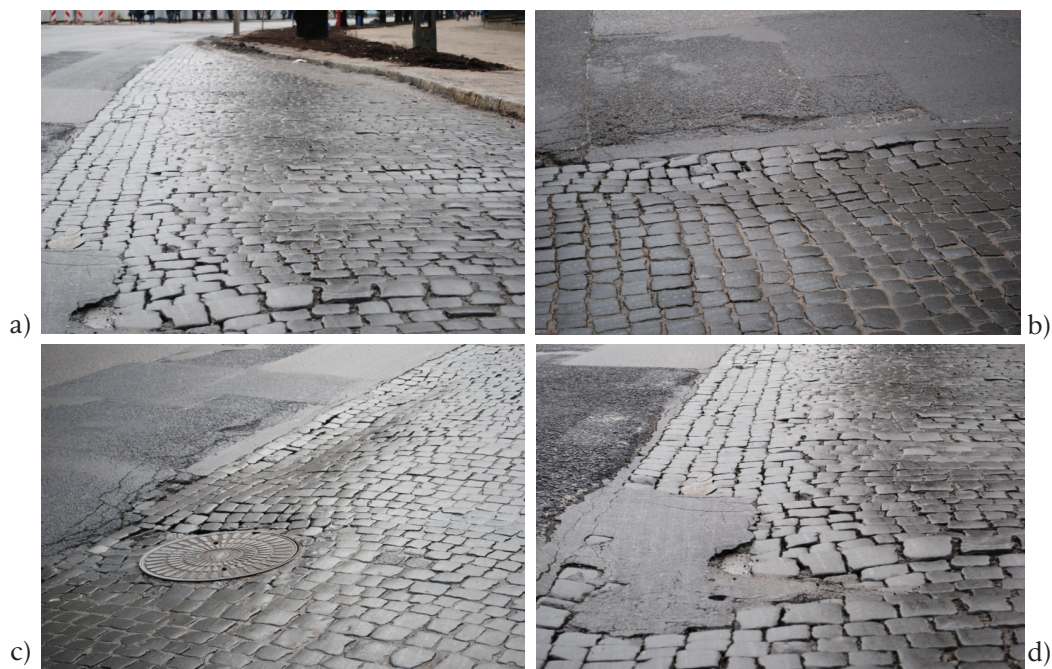
Fot. 2a - d. Uszkodzenia konstrukcji zatoki autobusowej z kostki bazaltowej a) poprzeczne przemieszczenia kostek, b), d) osiadanie nawierzchni na styku zatoki z jezdnią c) osiadanie nawierzchni przy studzience rewizyjnej [15].
