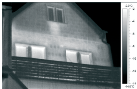
Rys. 6. Przykład termogramu górnej części elewacji domu jednorodzinnego (komentarz w tekście)
