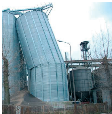
Rys. 2. Awaria stalowego silosu na zboże
