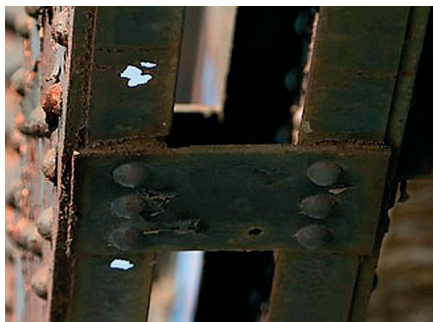
Rys. 1 Widok uszkodzenia korozyjnego (wżeru skośnego) elementu konstrukcji mostu
