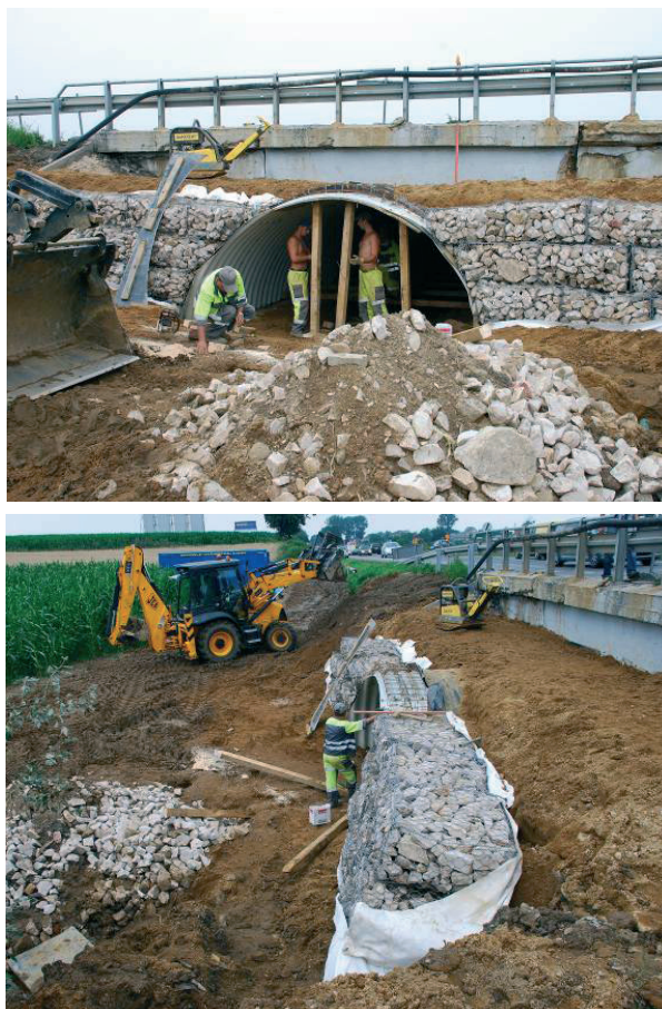
Fot. 4. Montaż konstrukcji stalowej z blachy falistej wraz z ustawieniem gabionów [10]. Phot. 4. Assembly of corrugated steel with setting gabions [10].
