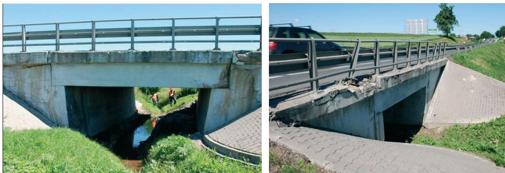
Fot. 3. Widok mostu wraz z uszkodzeniami: od strony napływu i od strony odpływu [10].
