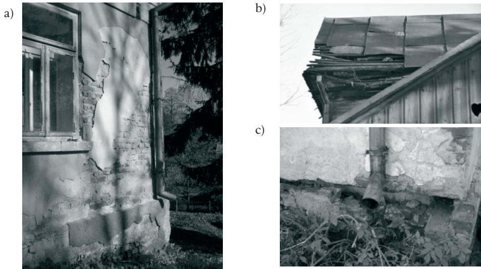
Rys. 3. Zniszczenia elewacji: a) uszkodzenia tynku elewacji południowej, b) ubytek pokrycia dachowego elewacji zachodniej, c) ubytki cegieł odsłaniające kanał wentylacyjny podłogi – elewacja północna.
