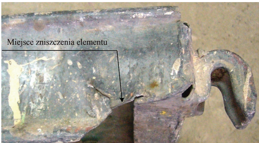
Rys. 15. Uszkodzenia w strefie połączenia blachy przedniej i środkowej.
