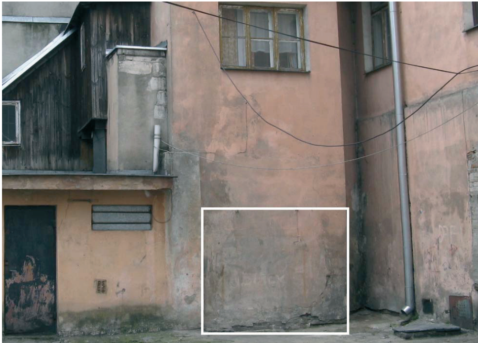
Rys. 4. Powierzchnia zewnętrzna omawianej przegrody (prostokątem oznaczono badany obszar) z wyraźnymi oznakami zniszczenia i korozji biologicznej wywołanymi podciąganiem kapilarnym, (źródło: opracowanie własne).
