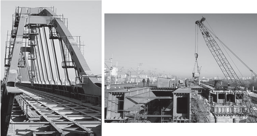
Fot. 12. Widok jednego z łuków wsporczych mostu; Przekrój części drogowej [5.4.3]. Phot. 12. One of arches under construction; cross-section of bridge – road segment.
