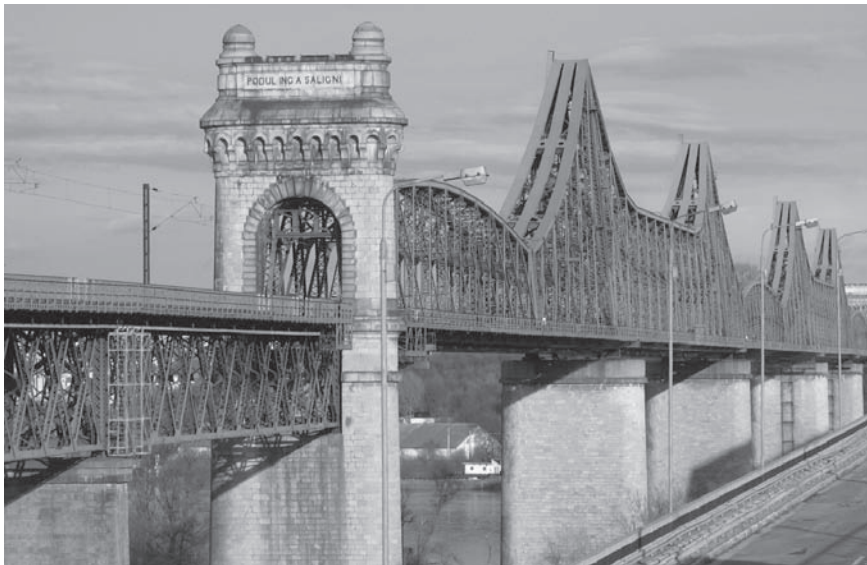
Fot. 2. Widok ogólny mostu kolejowego Króla Karola I [5.1.4]. Phot. 2. Overall view of King Karol I railway bridge [5.1.4].
