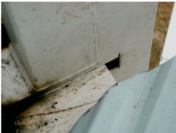
Fot. 3. Nieprawidłowo wykonane nacięcie. Photo 3. The incorrect cut gap.
