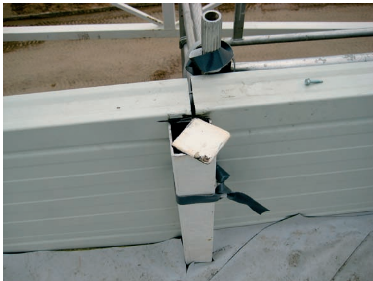
Fot. 9. Niedokończone zabezpieczenie antykorozyjne attyki. Photo 9. The incorrect attic's anticorrosion protection.
