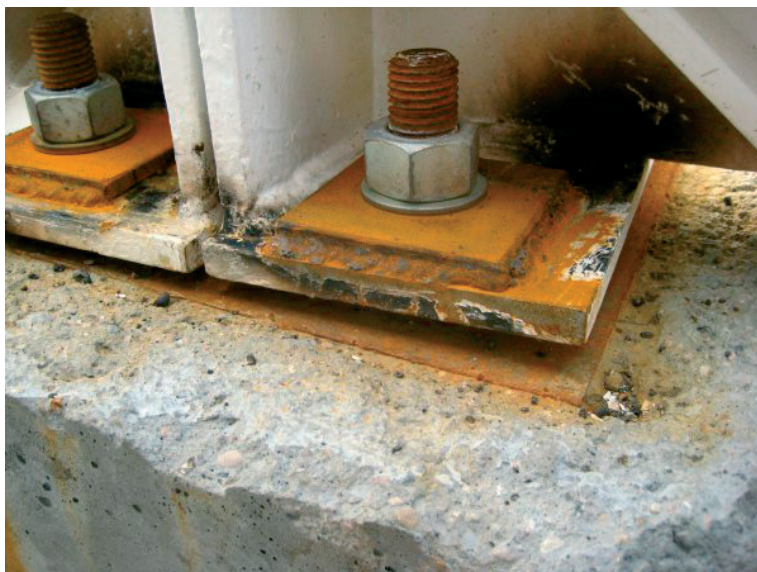
Fot. 11. Brak zabezpieczenia antykorozyjnego po wykonaniu spoiny montażowej. Photo 11. Field weld without anticorrosion protection.
