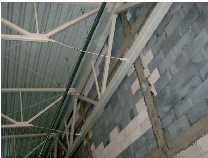
Fot. 5. Brak naciągu stężenia. Photo 5. Bracing without tension.
