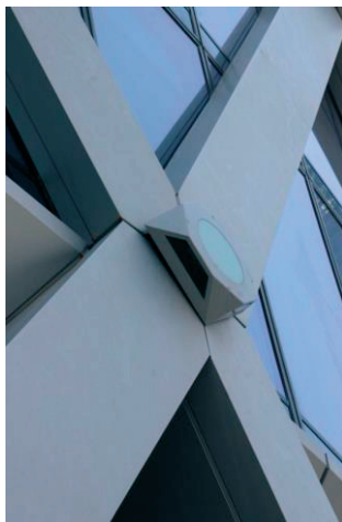
Rys. 14. Tornado Tower – element diagonalnej siatki w formie stalowej kratownicy pokrytej aluminiową nakładką ze śrubą, fot. wykonana przez autorów
