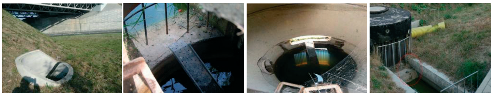
Fot. 15-18. Pochylnia w studni wpadowej oraz spiralny element ucieczkowy i przegęszczenie prętów na studni wpadowej
