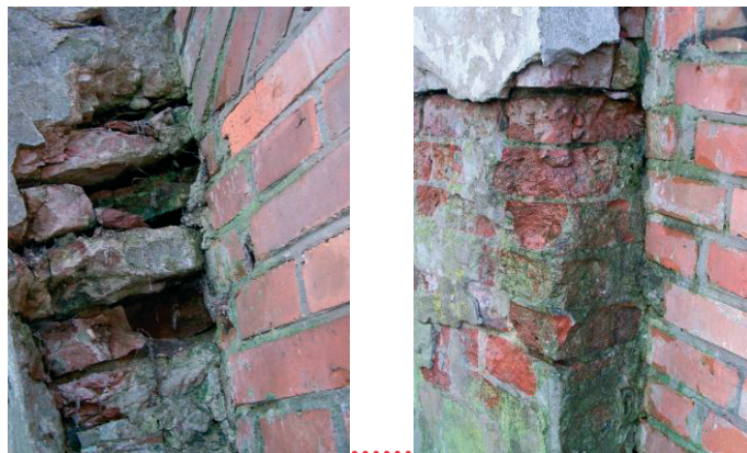
Fot. 4. Mostek nad dawną „Głęboką Drogą” w Puławach, 2016 r. Miejsca połączeń ustroju nośnego mostku i muru oporowego. Zniszczenia cegły i zaprawy spowodowane przemarzaniem
