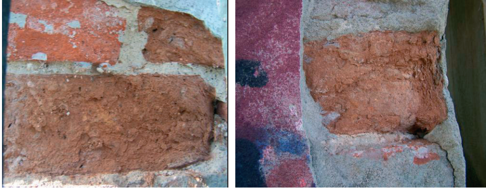
Fot. 5. Mostek nad dawną „Głęboką Drogą” w Puławach, 2016 r. Brama portalowa, zniszczenia cegły i spoiny spowodowane krystalizacją soli budowlanych
