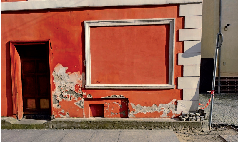
Rys. 2. Zawilgocenie ściany powyżej żelbetowej podwaliny oraz miejscowe pęcherze świadczące o braku przyczepności tynku do podłoża
