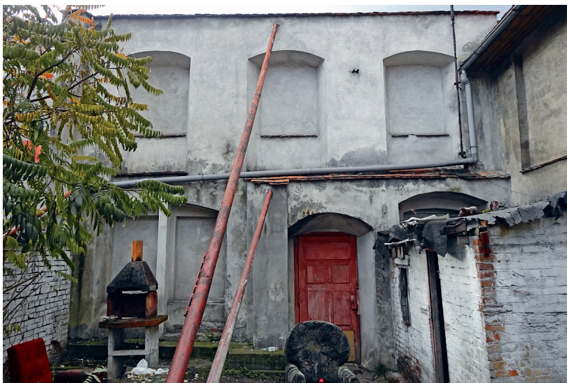
Rys. 4. Dwa ściągi usytuowane w połowie szerokości ściany frontowej
