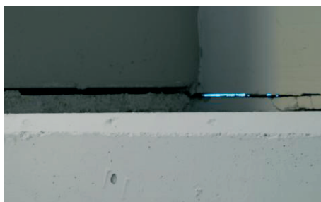
Rys. 6. Widok dylatacji stropu od dołu – widoczna niewypełniona szczelina dylatacyjna
