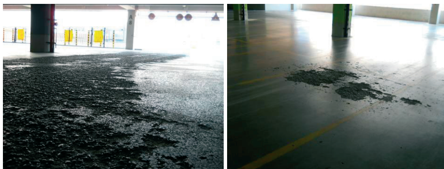
Rys. 3. Uszkodzenia powierzchni betonu: płyta na gruncie w strefie wjazdu na poz. -2 (z lewej), strop międzykondygnacyjny na poz. -0,5 (z prawej)
