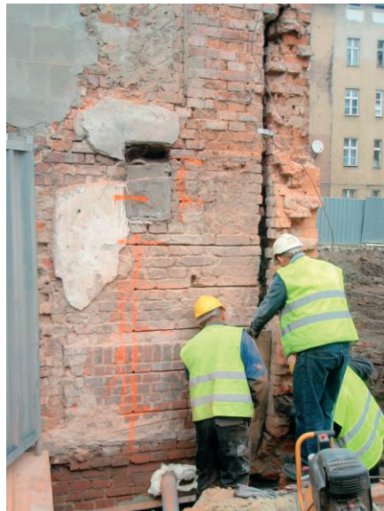
Rys. 5. Pęknięcie rozwarstwiającej ścianę szczytową od reszty budynku zabytkowego
