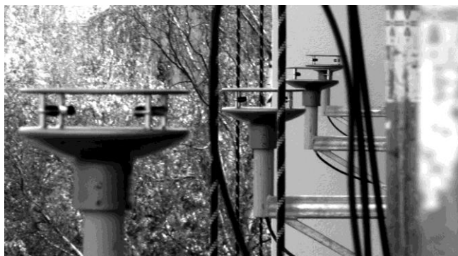
Rys. 14. Grupa czujników zamontowana na rusztowaniu elewacyjnym
