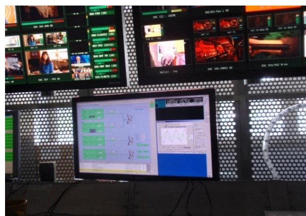
Fig. 3. Monitoring Centre of Cyfrowy Polsat S.A. (Warsaw) [29]
