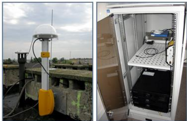
Rys. 5. Infrastruktura techniczna stacji referencyjnej RYKI [14]
