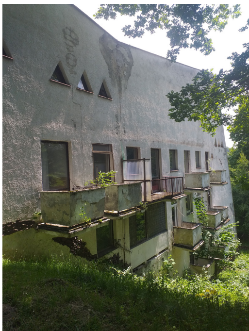
Ryc. 3. Arch. arch. J. Winnicki, Cz. Kotela, I. Kotela, Z. Winnicki – nieużytkowany „punktowiec” w Jaszowcu prezentuje oryginalne detale i rozwiązania materiałowe o znacznym stopniu destrukcji (fot. B. Ciarkowski)
