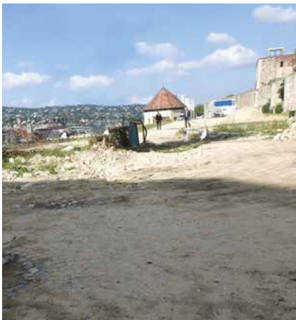
Fig. 3 The site of the Riding Hall, in Budapest, before the 2021 reconstruction [source: Várkapitányság Integrált Területfejlesztési Központ Nonprofit Zrt. (2022), p. 15]
