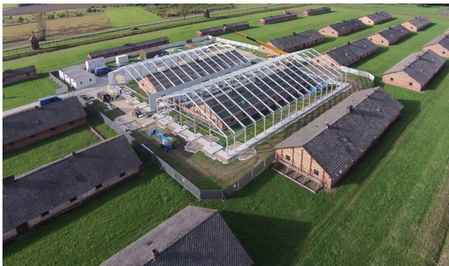
Fot. 5 Prace konserwatorskie prowadzone w barakach murowanych odcinka BI, (fot. B. Bartyzel)
