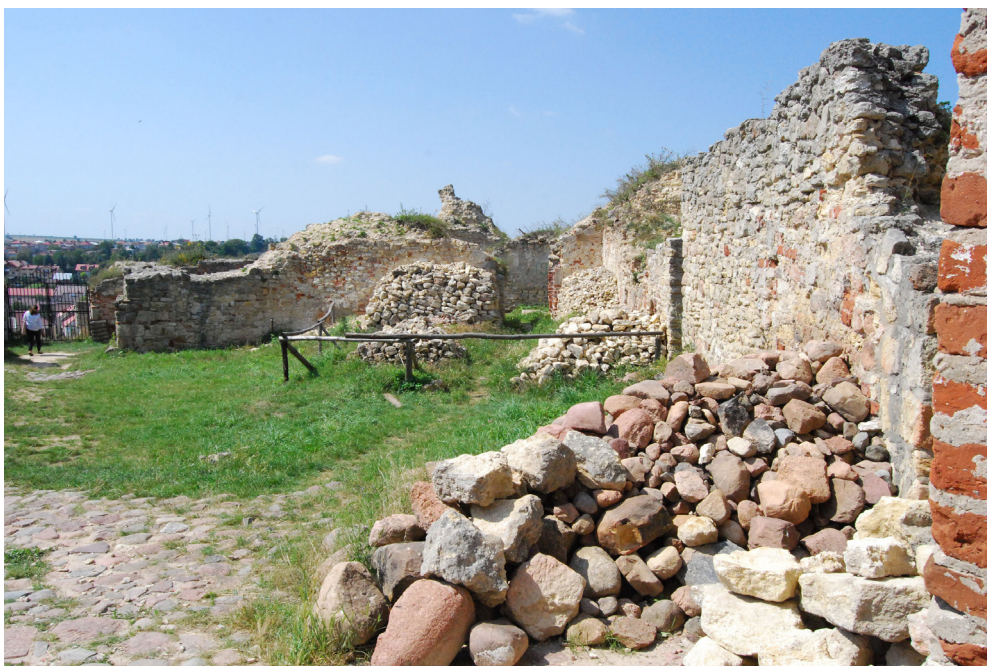
Ryc. 2 B Mury zamku górnego w Iłży, stan w 2018 roku, Fot. J. Lewicki
