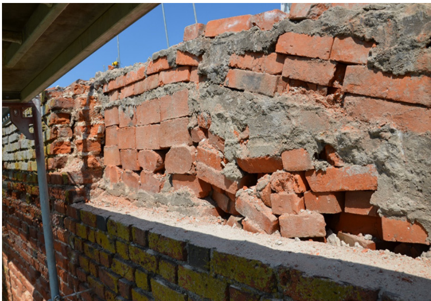
Ryc. 8 Jakość prac zabezpieczających wykonanych w latach 80-tych można było ocenić po usunięciu wierzchnich warstw – dokumentacja procesu Rewitalizacji – etap I – zbiory MSM
