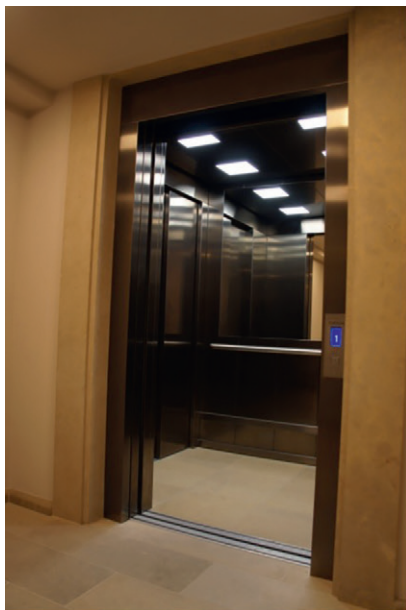
Fot. 20. Kabina dźwigu, rok 2020; fot. R. Jeżowski
