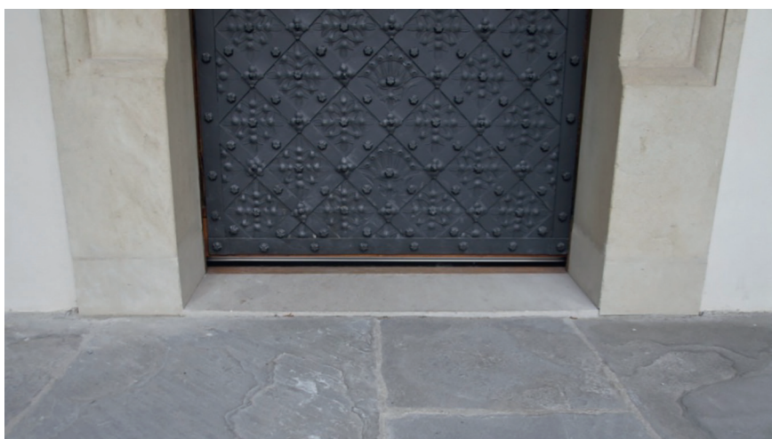
Fot. 11. Wejście na parterze krużganków po przebudowie – bez stopnia, rok 2020; fot. R. Jeżowski
