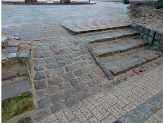
Fot. 7. Pochylnia stała w Parku Północnym niespełniająca potrzeb użytkowych, Sopot, fot. R. Stachańczyk 2022
