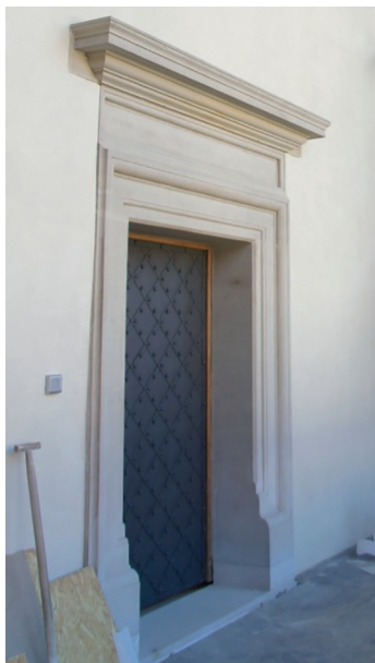
Fot. 12. Wejście na II piętrze krużganków po przebudowie – bez stopnia, rok 2018; fot. R. Jeżowski
