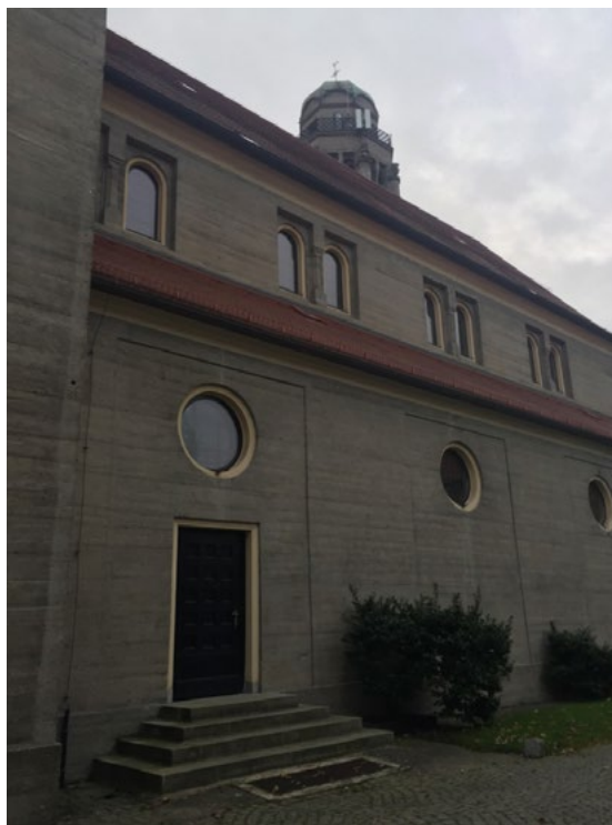
Ryc. 3. Fragment elewacji północnej z widocznymi śladami deskowań.
