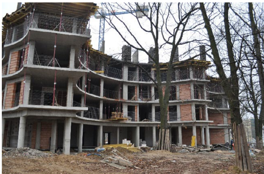
Ryc. 1. Zespół zabudowy mieszkaniowej „Kraśnicka Residence”: Budynek „B1” i „B2” w budowie. (fot. autor, grudzień 2020)
