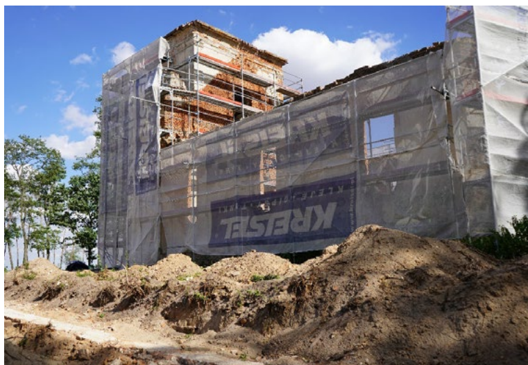
Ryc. 7. Fotografia przedstawiająca prace związane z zabezpieczeniem trwałej ruiny (rok 2019) – źródło Urząd Miasta Piaski
