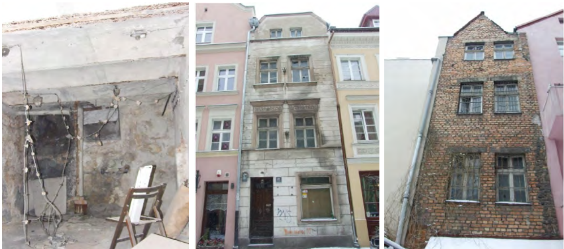
Ryc. 3. Po lewej: zdjęcie wnętrza kamienicy Wroniecka 23 – stan przed remontem; W środku: zdjęcie elewacji frontowej kamienicy Wroniecka 23 – stan przed remontem; Po prawej: zdjęcie elewacji tylnej kamienicy Wroniecka 23 – stan przed remontem
