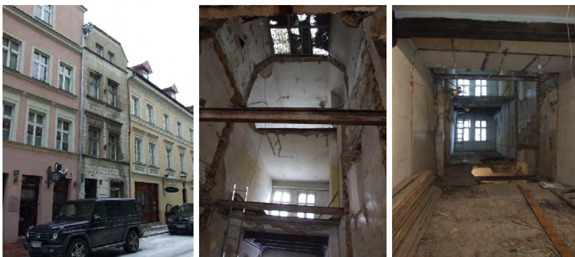
Ryc. 12. Zdjęcia, przedstawiające stan zastany kamienicy
