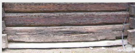
Ryc. 24. Chałupa z Bukowej, spękana i ugięta podwalina [11]
