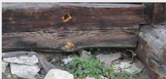
Ryc. 6. Chałupa z Brzezina, częściowy brak kamienia w podmurówce, ubytki i zniszczenia papy [4]
