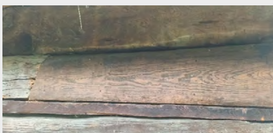
Ryc. 9. Chałupa z Brzezina, miejscowa wymiana skorodowanej belki
