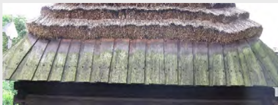
Ryc. 14. Chałupa z Bukowej, korozja biologiczna desek pokrycia dachowego [11]
