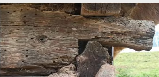
Ryc. 23. Chałupa z Brzezina, próba miejscowych uszczelnień, korozja drewna bez zmian
