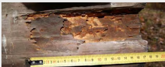
Ryc. 34. Chałupa z Błonia, uszkodzenie belki przez owady [12]
