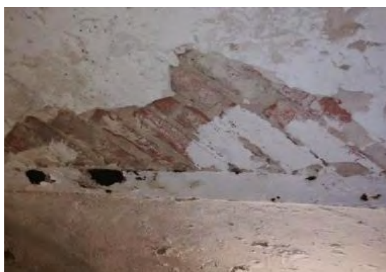
Fot. 30. Skorodowane belki stropu odcinkowego w piwnicy.
