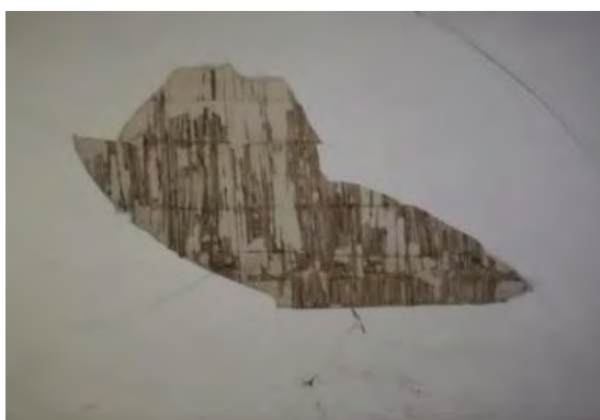
Fot. 29. Ubytek wierzchniej warstwy tynku odstaniający konstrukcję stropu nad parterem
