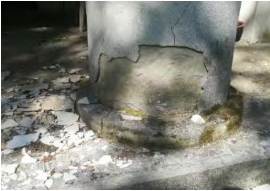
Fot. 31. Odspojenia tynku na kolumnie
