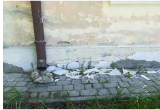
Fot. 32. Skorodowana rura spustowa. Liczne odspojenia struktury tynku na cokole. Niejednorodna powłoka malarska
