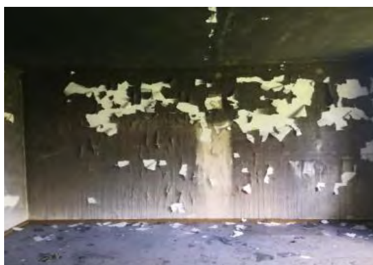
Fot. 28. Odspojona powłoka malarska, zacieki wodne w pokoju na poddaszu
