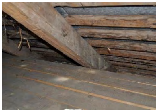
Fot. 26. Świeża mączka drzewna, świadcząca o aktywnym żerowisku szkodników technicznych
