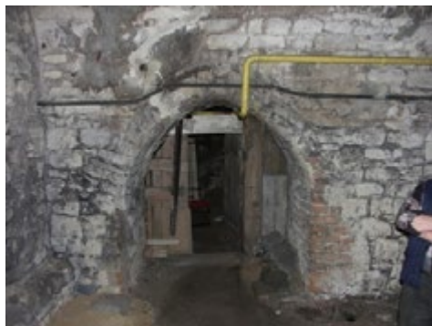
Ryc.11. Piwnica, część C, przejście do części B. Fot. K. Janus Fig. 11. Basement, part C, passage to part B. Photo K. Janus
