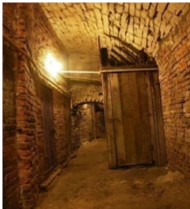
Ryc. 9. Piwnica, część F, widok na ścianę wschodnią. Fot. K. Janus Fig. 9. Basement, part F, view on eastern wall. Photo K. Janus
