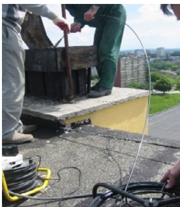
Ryc. 7. Badanie drożności wentylacji 11-kondygnacyjnego budynku prefabrykowanego Fig. 7. Ventilation ducts inspection in a 11-storey precast concrete plate building
