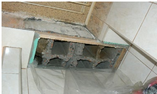
Ryc. 6 Wentylacyjne kanały zbiorcze budynek prefabrykowany – samowolnie wyburzone Fig. 6. Common ventilation ducts – a precast ventilation block removed by the thoughtless flat owner
