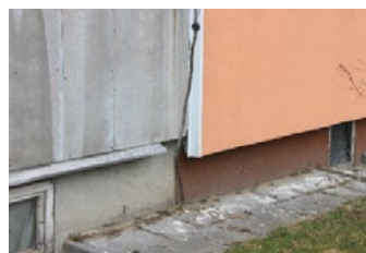
Ryc. 18. Fragment budynku prefabrykowanego na styku I i II etapu ocieplenia. Zły stan płyt okładzinowych i stolarki okiennej, brak ocieplenia cokołu w obu etapach ocieplenia Fig. 18. Second stage of insulation and old cladding of the first stage. Poor condition of old cladding and basement joinery, uninsulated basement wall.
