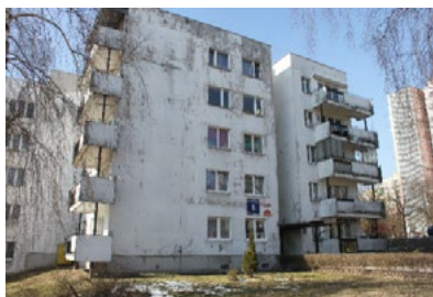
Ryc. 6. Noskowskiego 8. Budynek prefabrykowany z 1980 r. po ociepleniu w latach 90. i częściowej wymianie stolarki okiennej Fig. 6. A block at Noskowskiego 8. The building of nineteen-eighties – insulated in nineteen-nineties, with windows partially replaced
