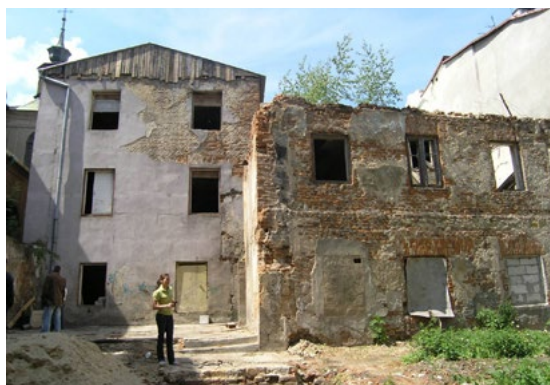
Ryc. 2. Zagrożona rozbiórką kamienica przy ul. Archidiańskiej 1 w Lublinie. Fot. Ze zbiorów WKZ Lublin
