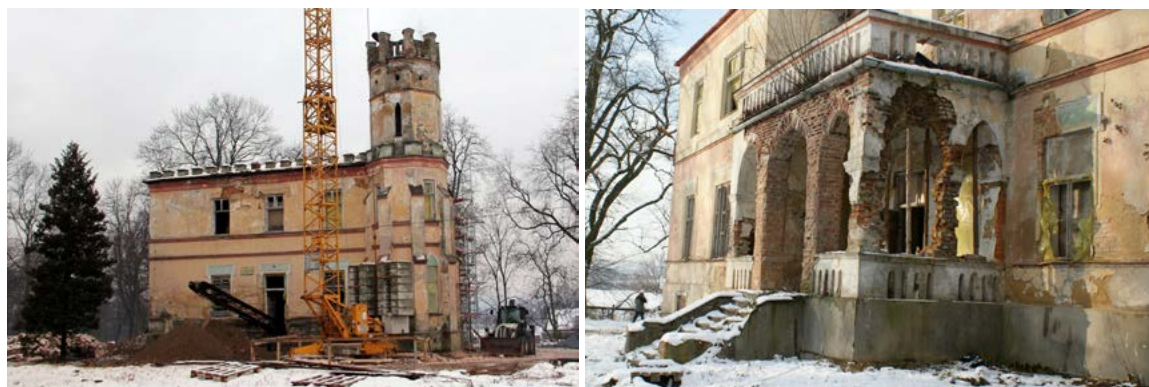
Ryc. 1. Pałac w Cianowicach, widok bryły pałacu, stan przed modernizacją, 2011 (źródło: dokumentacja Właściciela obiektu, dostęp 2015)
