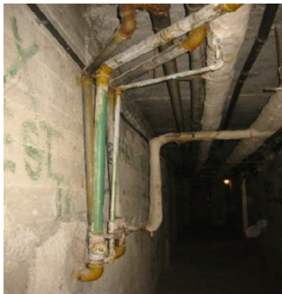
Ryc. 9. Budynek prefabrykowany piwnice, stan instalacji c.w.u. i c.o. Fig. 9. A precast concrete plate building: condition of hot water and central heating systems
