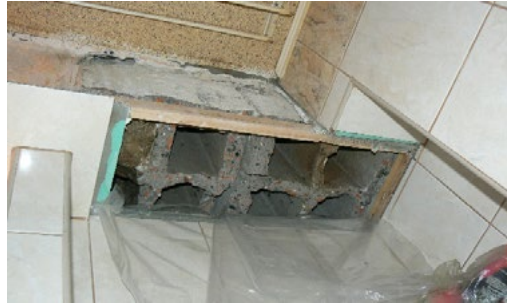
Ryc. 6 Wentylacyjne kanały zbiorcze budynek prefabrykowany – samowolnie wyburzone Fig. 6. Common ventilation ducts – a precast ventilation block removed by the thoughtless flat owner
