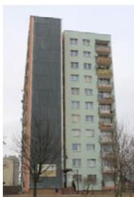
Ryc. 20. Króla Rogera 6. Budynek prefabrykowany z 1986 r. po ociepleniu w latach 90. i częściowej wymianie stolarki okiennej. Widok ogólny od strony północno-wschodniej Widok ogólny od strony południowej
