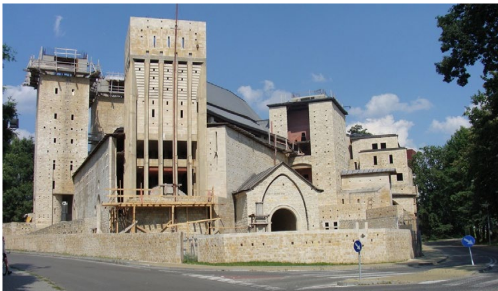
Ryc. 11. i 12. Klasztor Franciszkanów w Tychach. Widoki z przestrzeni przylegających ulic. Źródło: fot. H. Trammer, 1 sierpnia 2009 r. Fig. 11. & 12. Franciscan Monastery in Tychy. View from the space of the surrounding street. Source: phot. Hubert Trammer, August 1 st , 2009
