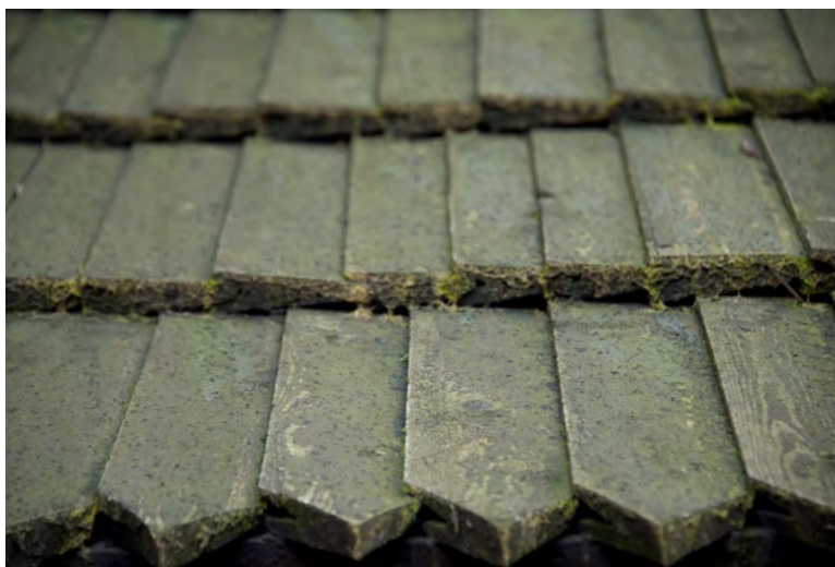
Ryc. 7. Nalot mchu na gonce elewacji północnej, fot. M. Petri
