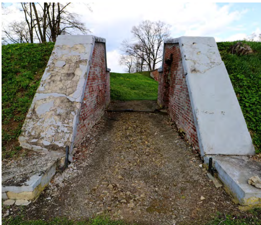
Ryc. 3. Fotografia przedstawiająca zabezpieczenie przejścia przez wał ziemny w Fortcie XV Borek – zdjęcie Piotr Gleń
