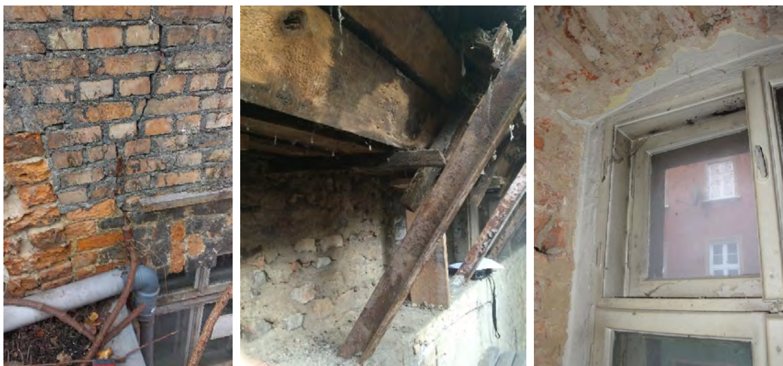
Ryc. 11. Zdjęcia obrazujące stan techniczny struktury budynku
