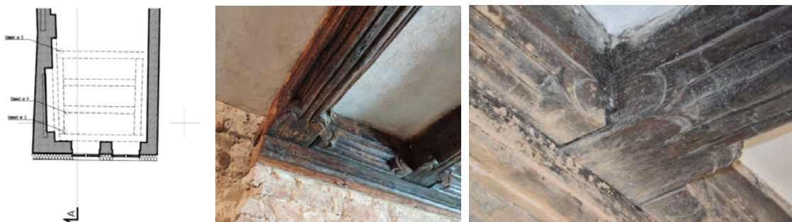
Ryc. 10. Belki drewniane – pozostałości stropu drewnianego zlokalizowane pod stropem 1 piętra w budynku Wroniecka 23
