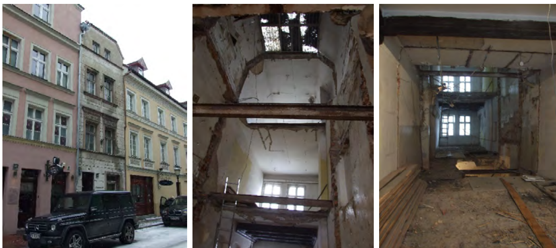
Ryc. 12. Zdjęcia, przedstawiające stan zastany kamienicy
